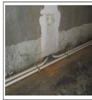
地面管线接墙
