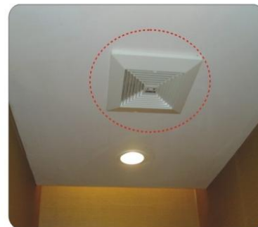
检修口、出风口实景图
